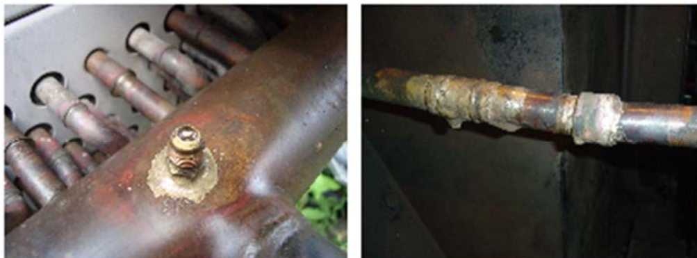
Figuur 4, Voorbeelden van visuele indicatoren die op lekken kunnen wijzen
