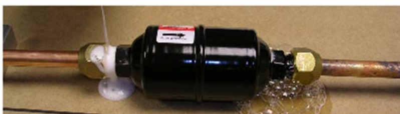
Figuur 3, voorbeeld van het ontstaan van bellen ten gevolge van een lek
