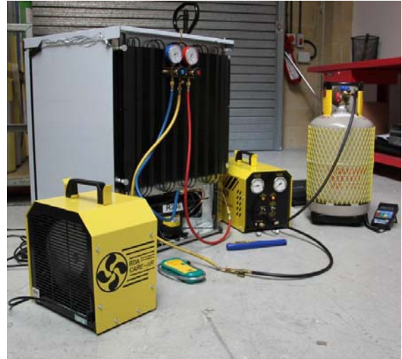
Figuur 5, Voorbeeld van gereedschappen die worden gebruikt bij het onderhoud van een KWS-installatie
