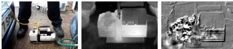
Een lekkende vacuumpomp.
